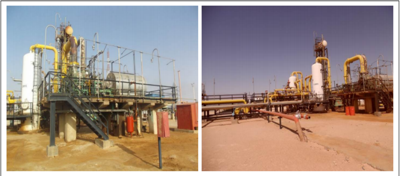
FIGURE 1.11 – Compresseurs de gaz et réservoirs huile lubrifiante – section compression-
