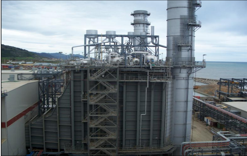
Figure 8 La chaudière de récupération de chaleur (HRSG)
