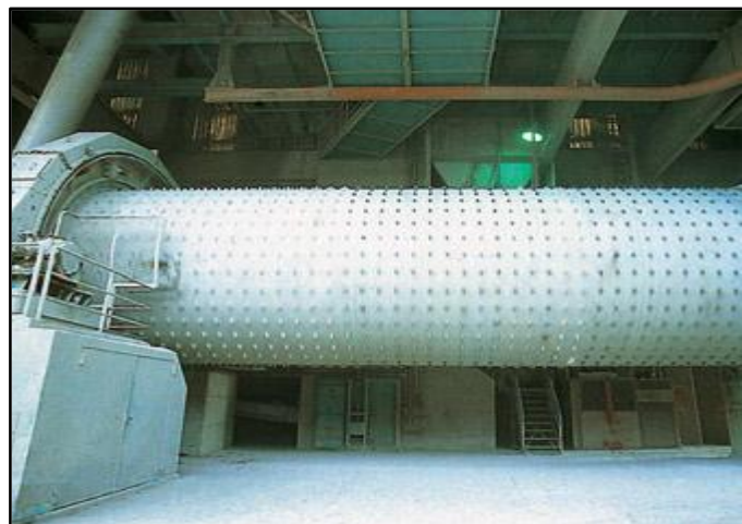
Figure 1-7 : Vue d'un broyeur du clinker [LAFARGE]
