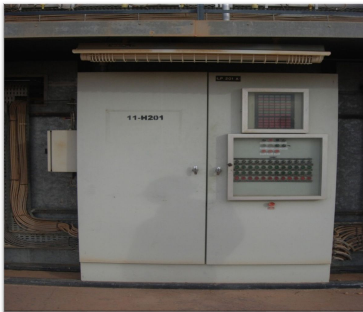
Figure 4.3 - tableau local du four H201
