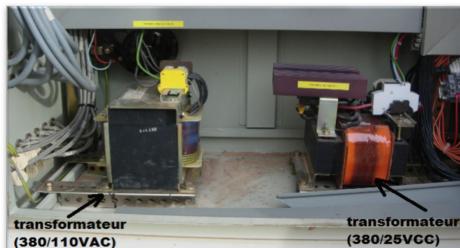
Figure 4.4 – Les transformateurs d'alimentation
