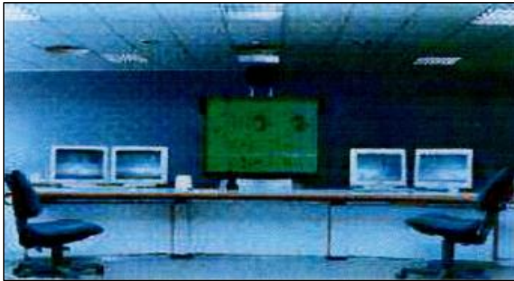
Figure 17 : La salle de commande.
