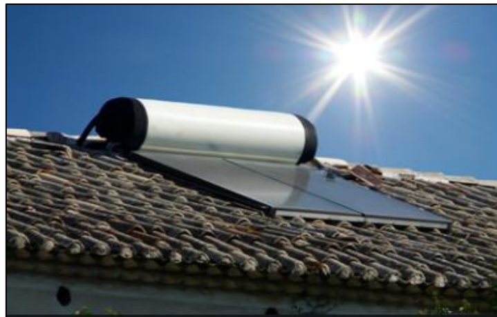
Figure 4: chauffe-eau solaire placé sur le toit d'une habitation [32]
