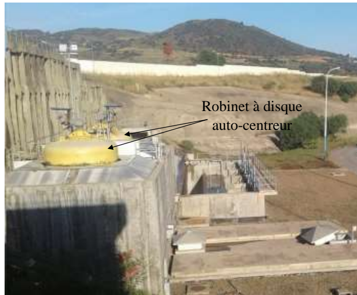
Fig 2. 14 : Les deux robinets brise-charge de la filière 1
