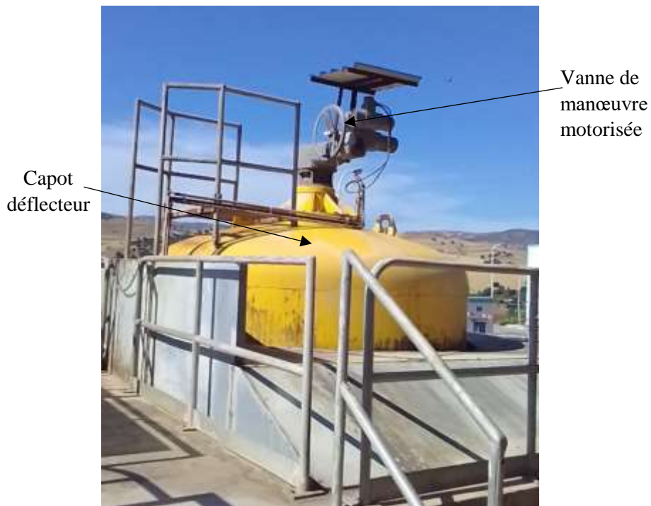
Fig 2. 15 : Robinet à disque auto-centreur sous capot de la station de traitement de Qudiet Acerdun
