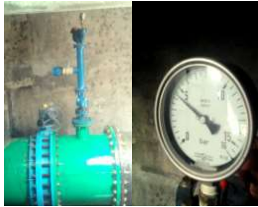
Fig 2. 19 : Mesure de la pression en amont du brise charge
