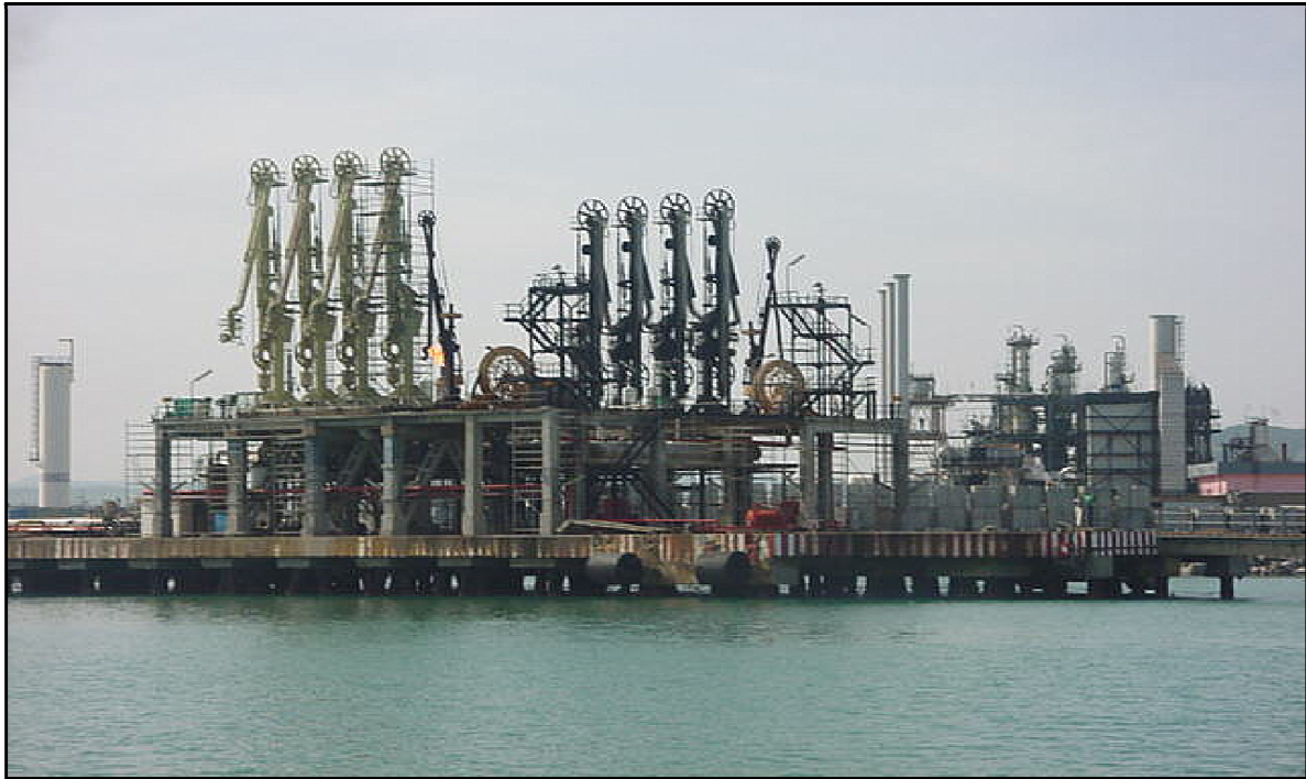
Figure I.9: Postes de chargement du GNL (M1 et M2) [2]
