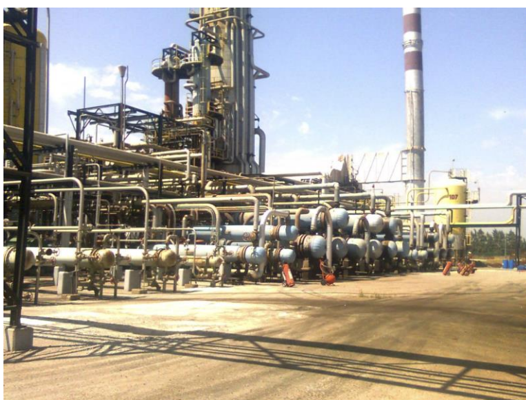
Figure 1.3 – Train de préchauffe (batterie d'échangeurs)
