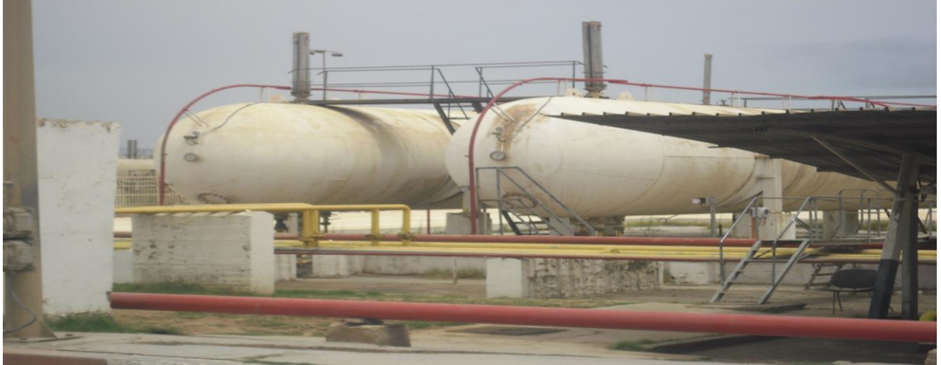
Figure 1- 8 : Zone de stockage de propane
