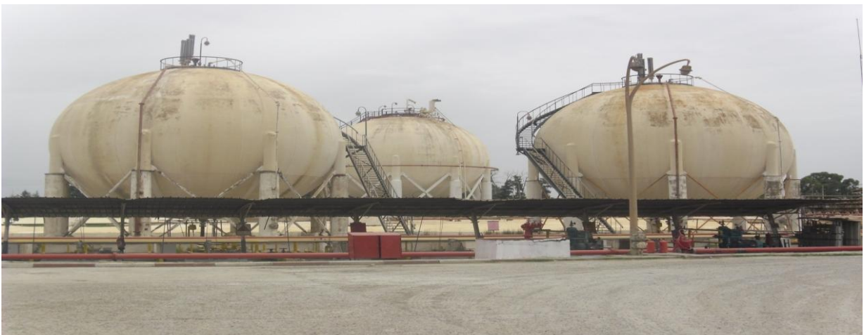
Figure 1- 7 : Zone de stockage de butane
