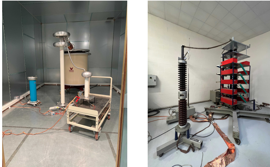
FIGURE 3.1 – Laboratoire électrique de SADTEM
