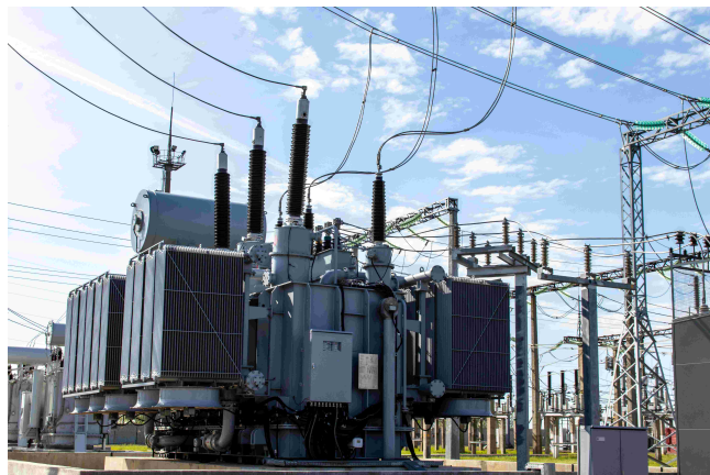
FIGURE 1.16 – Transformateur de puissance triphasé [8]
