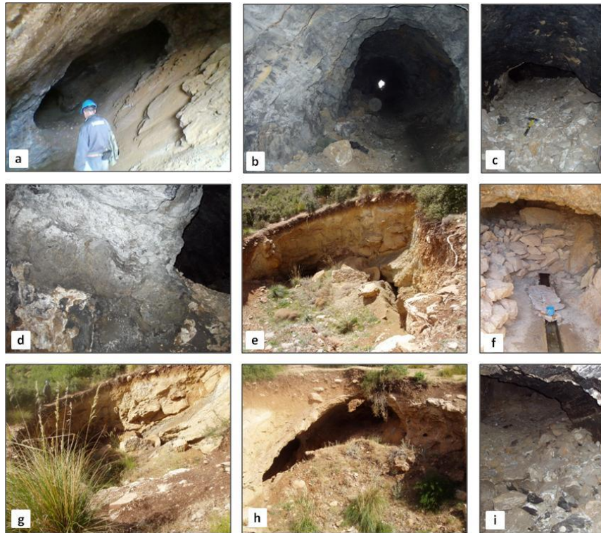
Figure 2. 8 : États des ouvrages miniers souterrains de la mine abandonnée Ichmoul (les photographies ont été prises par l'auteur).
