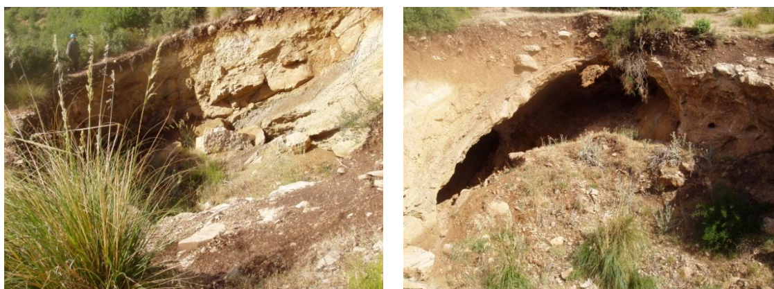
Figure 2.14 : Cas d'affaissement et d'effondrement des ouvrages miniers souterrains dans le site minier d'Ichmoul ((les photographies ont été prises par l'auteur).
