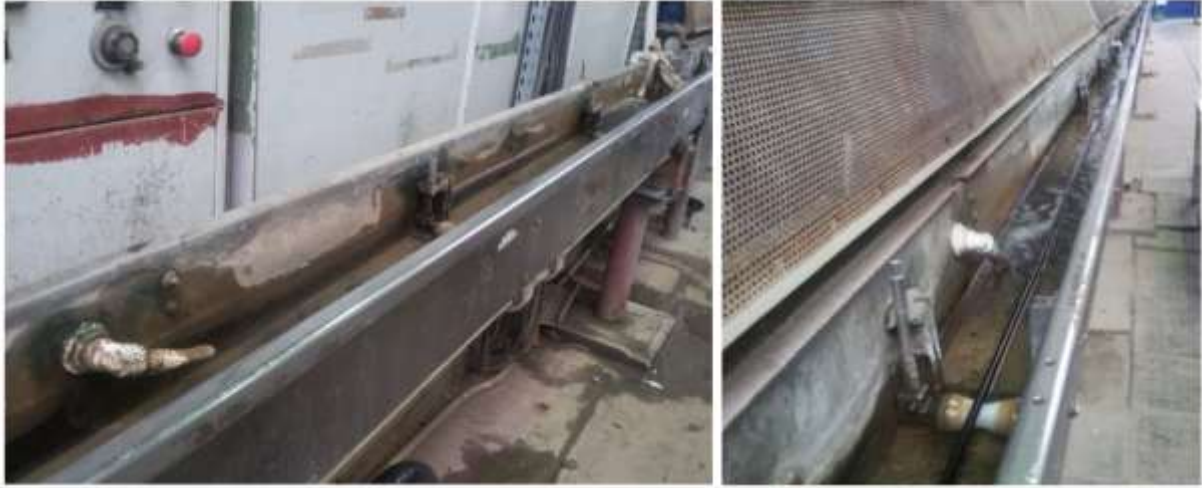
Figure 3-12 : les bacs d'eau
