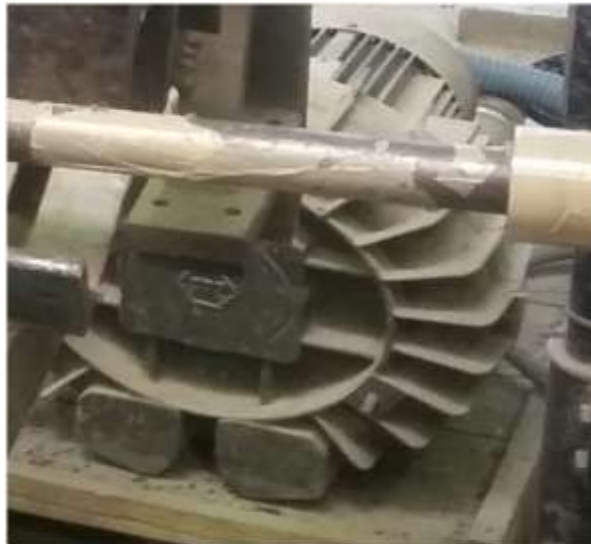
Figure 3-11 : l'image de la pompe à vide
