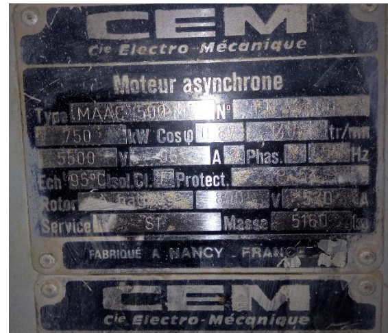
Figure 2. 2 Plaque signalétique du ventilateur « atelier broyage cru »
