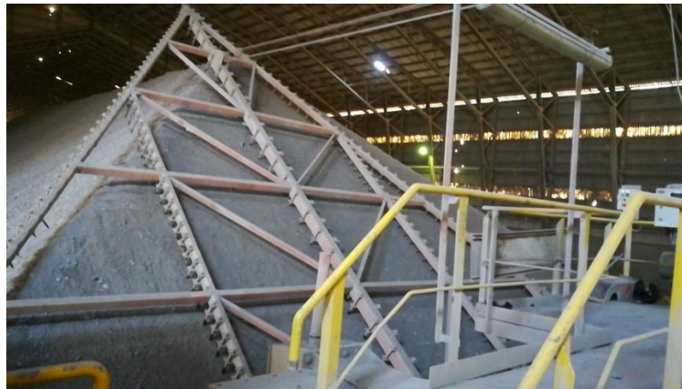
Figure 1. 7 Préhomogénéisation du calcaire par pont grateur
