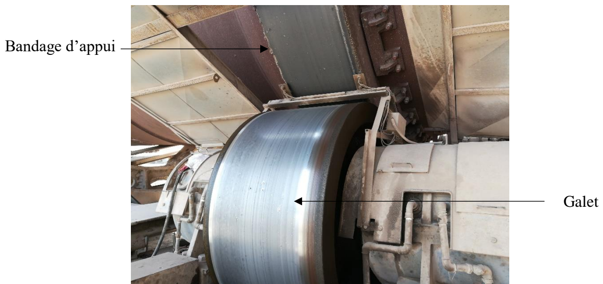
Figure 3. 4 Usure non uniforme d'un galet de support du four de la SCSEG
