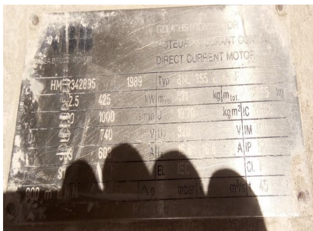
Figure 2. 3 Plaque signalétique du moteur « atelier four »
