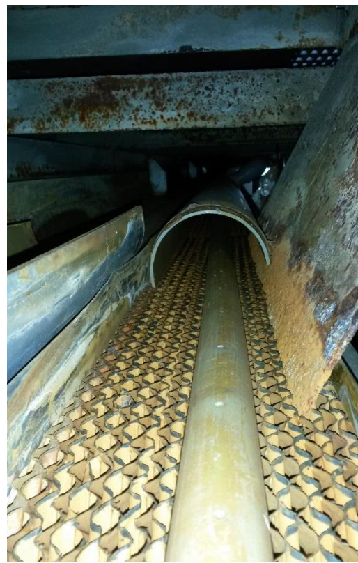
Figure 2-2 - Conduite de distribution de l'eau située en haut du média
