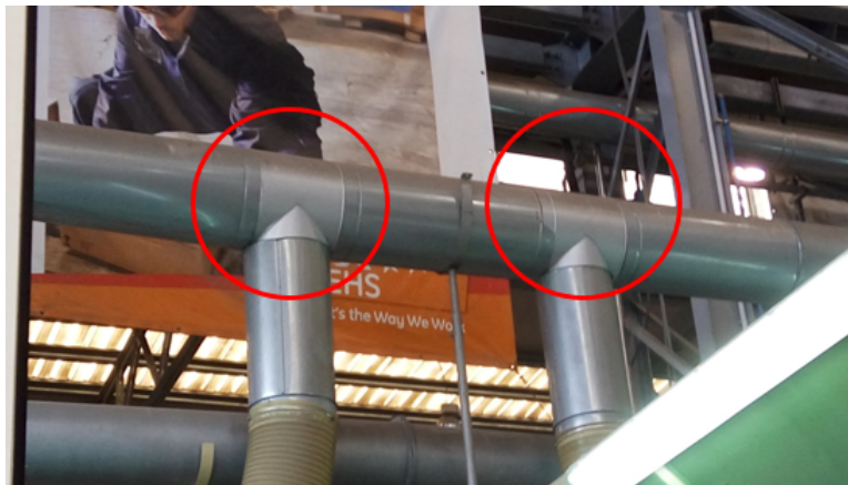
FIGURE 2.19: Deux soutirages consécutifs hors normes pour le système d'aspiration de particules
