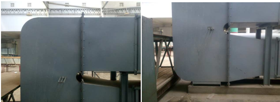
Figure2.6 : La canalisation qui relie les deux parties de la soufflerie(coudes de guidage)
