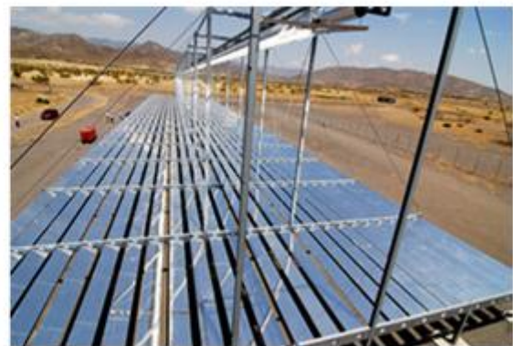
Fig.1.7 : La centrale solaire à miroir de Fresnel de Almería en Andalousie
