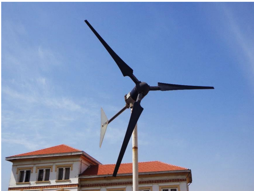
Figure 3.1 éolienne Whisper 100 installée à l'ENP.
