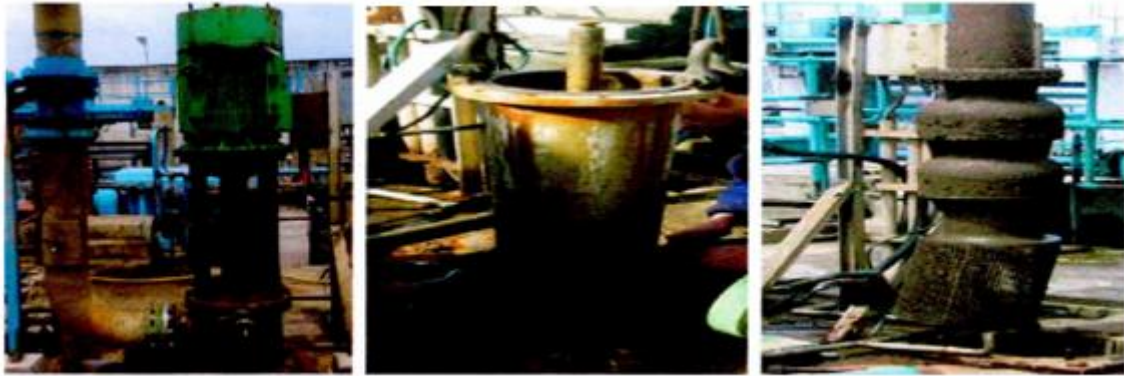
Tête de commande colonne d'eau de refoulement cote hydraulique
