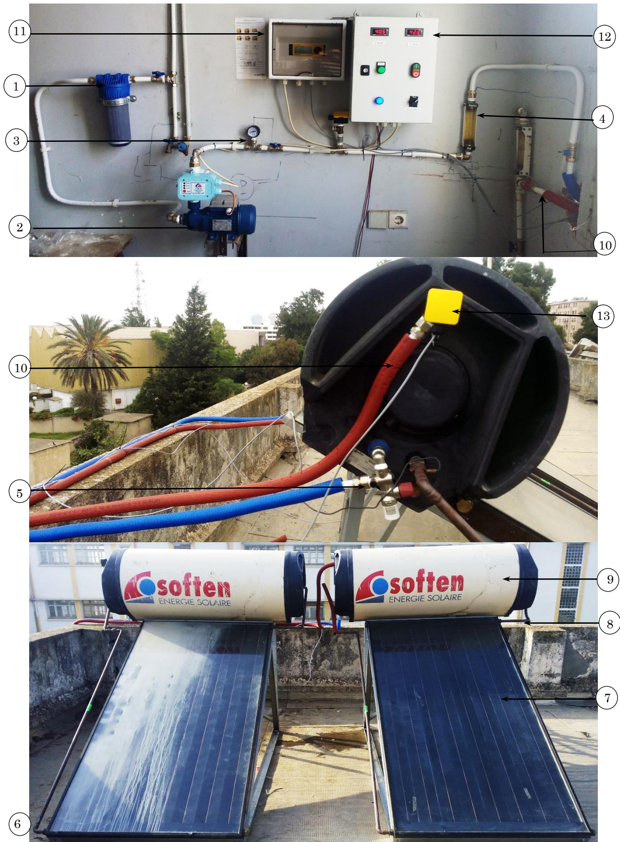
Figure 6.2 Vue générale de l'installation
