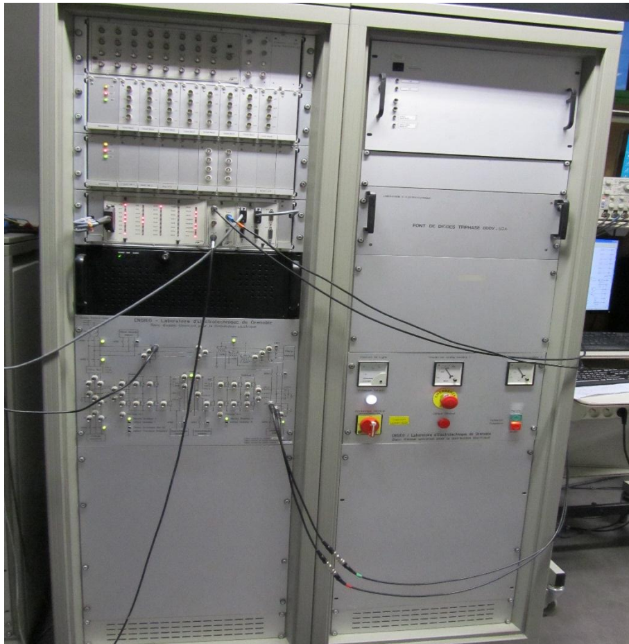
Fig. VI.3. Baie de puissance dédiée au pilotage de la MADA.
