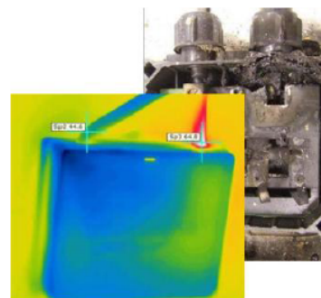
(b) corrosion dans la boîte de jonction
