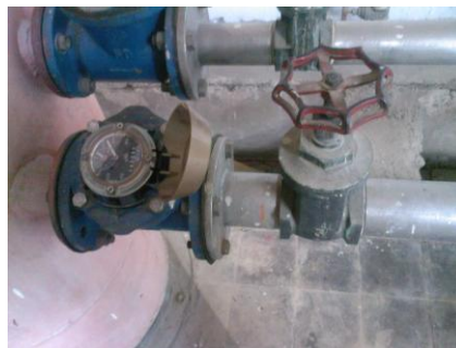
Figure III.2 : Le débitmètre et la vanne de la conduite d'alimentation du réservoir
