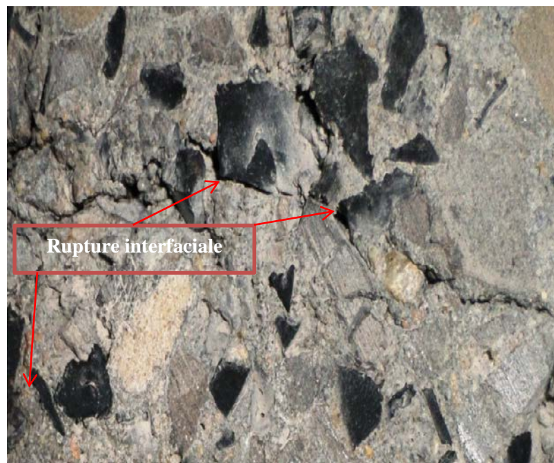
Fig. 5.5 . Rupture interfaciale entre les particules de caoutchouc et la pâte de ciment.
