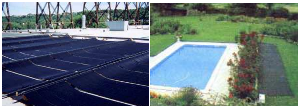
FIG 1-19 : Moquette solaire pour chauffage de piscine
