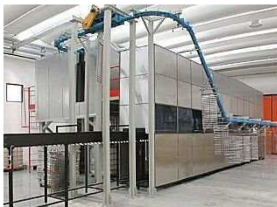
FIG 4-3 : Installation de peinture par immersion
