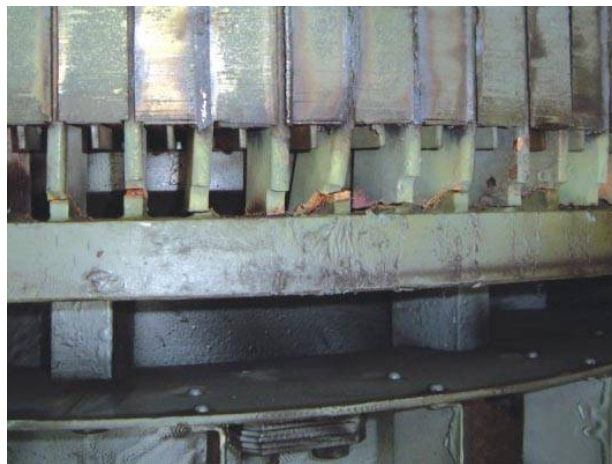
FIGURE I.13 – Rupture de plusieurs barres rotoriques
