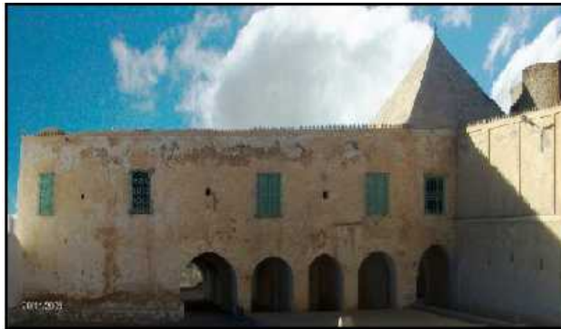
Figure III.49 : Effet des sels et des eaux de pluies sur la construction (Zaouïa de Ghemar) [34].
