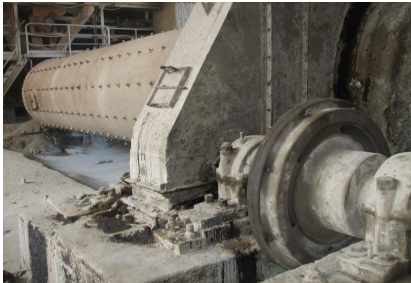
Figure II.2 : Le broyeur ciment AC BK II (vue sur site)
