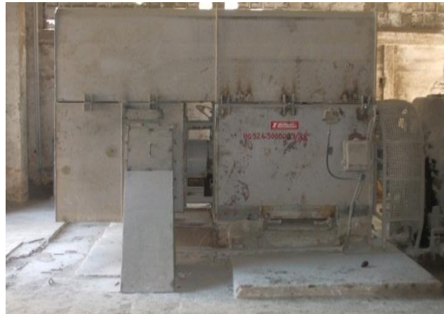
Figure II.3 : MOTEUR vue sur site
