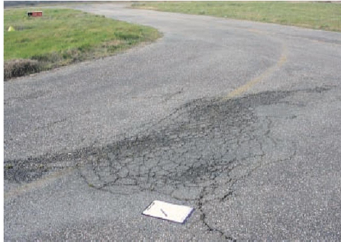
Figure II.7 : Faïençage de fatigue
