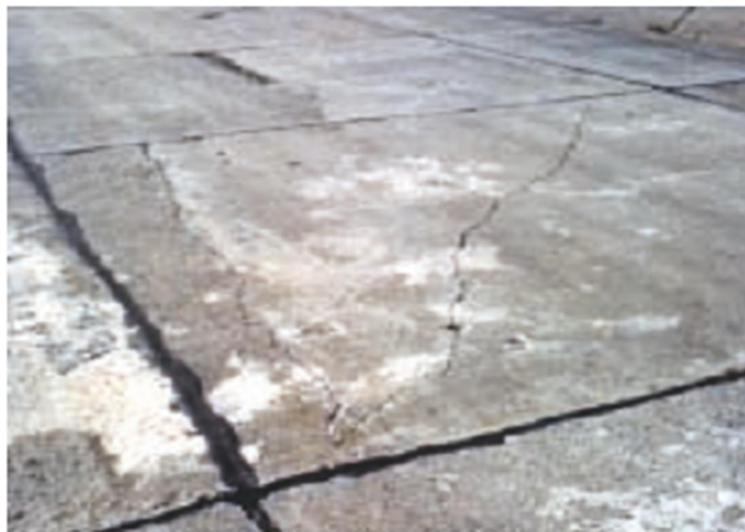
Figure II.17 : Fracture de dalle en trois morceaux
