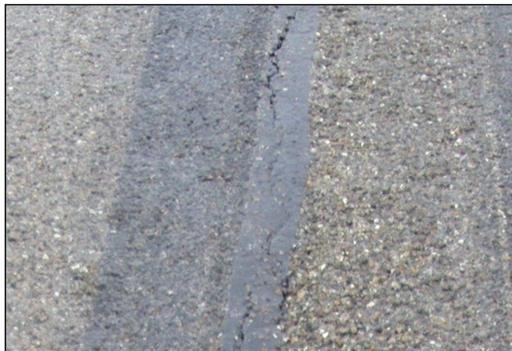
Figure II.29 : Fissure de fatigue traitée par pontage
