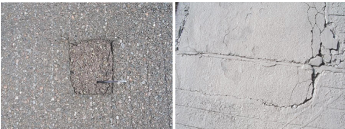
Figure II.23 : Réparation ponctuelle dégradée
