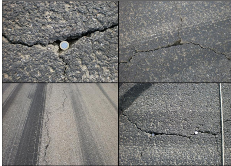
Figure II.28 : Fissure de fatigue sur l'aérodrome d'Alger
