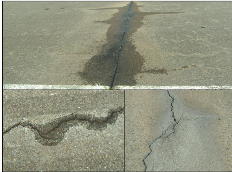
Figure II.30 : Remontées d'eau ou de fines sur l'aérodrome d'Alger
