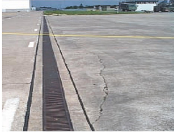
Figure II.15 : Fissure de gravité moyenne
