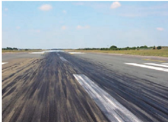
Figure II.24 : Dépôt de gomme
