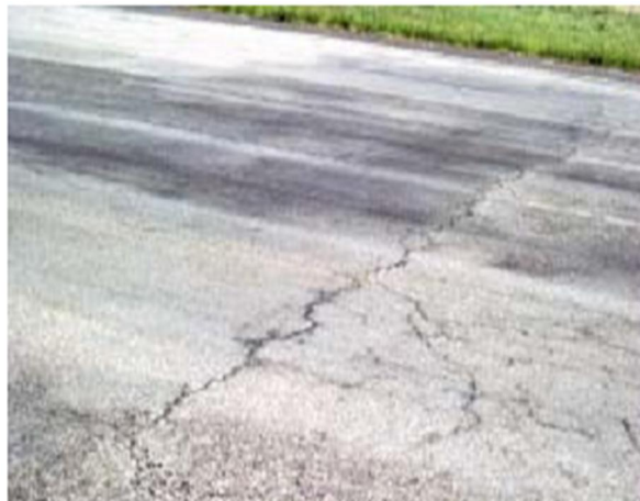
Figure II.9 : Fissure de retrait
