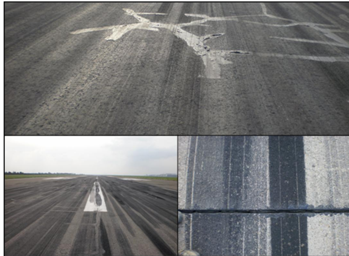
Figure II.32 : Dépôt de gomme sur l'aérodrome d'Alger
