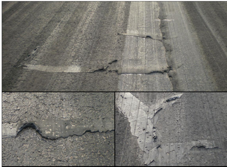
Figure II.34 : Excès de pontage sur l'aérodrome d'Alger
