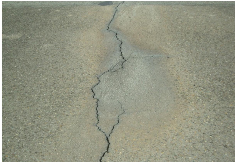
Figure II.26 : Fissure transversale sur l'aérodrome d'Alger
