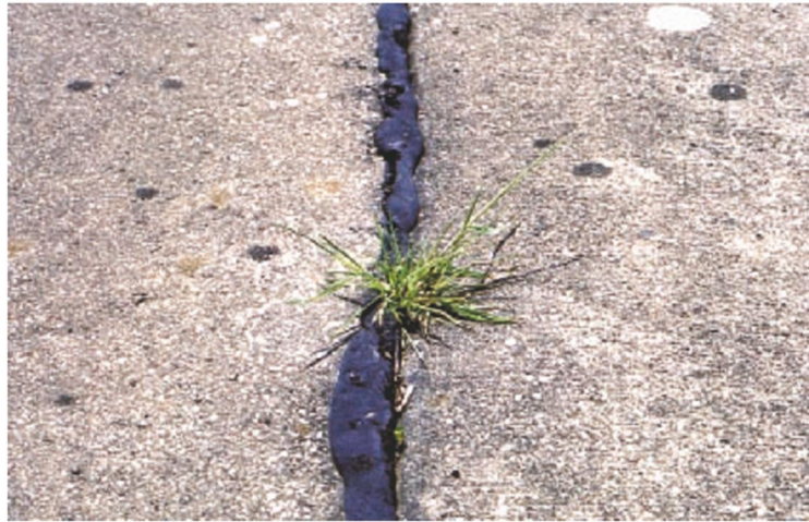
Figure II.22 : Défaut de joint (mauvaise adhérence relevée par la présence de végétation)
