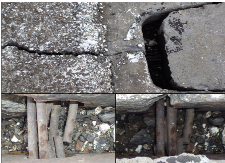
Figure II.35 : Cisaillement de câbles de précontrainte sur l'aérodrome
