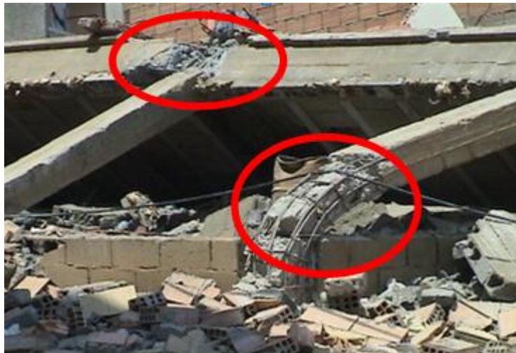
Figure.II.6: Exemple de dommages d'un bâtiment après un tremblement de terre de Boumerdes 2003. [4]
