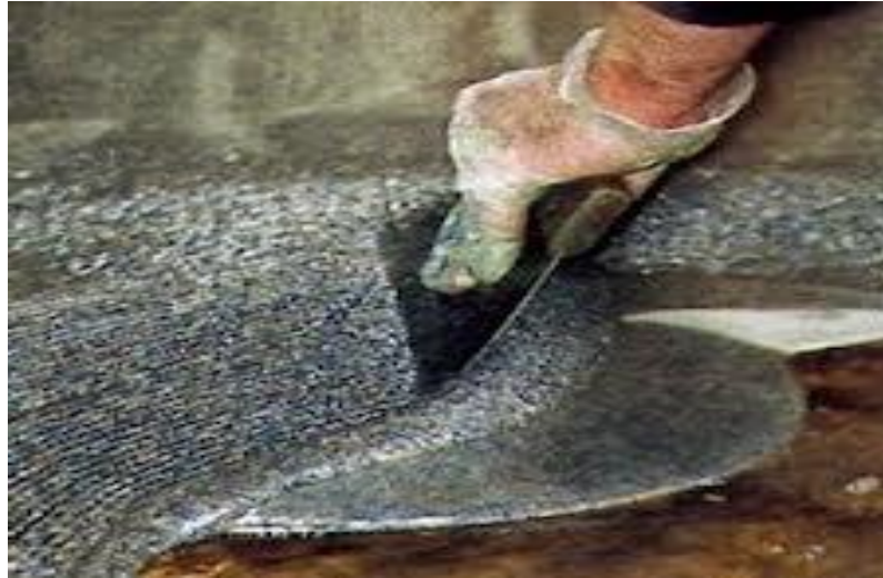
FigI.3. Revêtement à base de résine.
