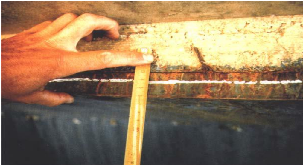
Figure II.13 Désordre au niveau de la connexion : décollement entre dalle et poutre
