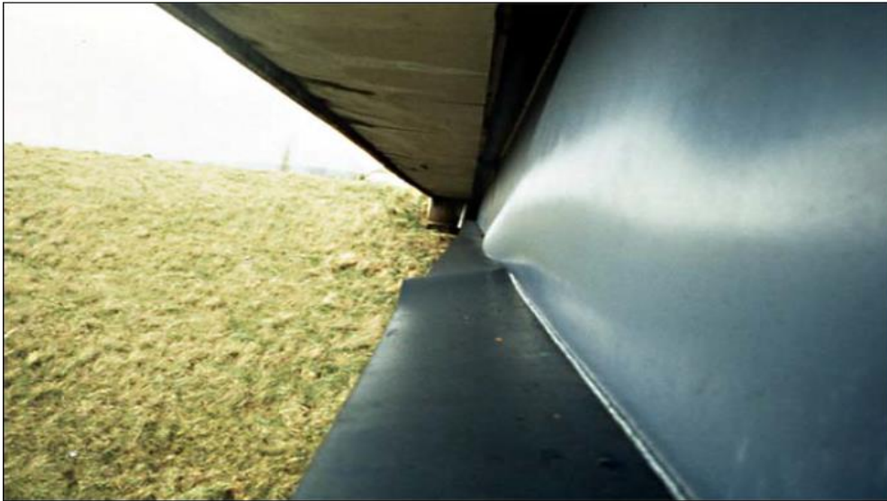
Figure II.9 Voilement d'âme d'une poutre métallique
