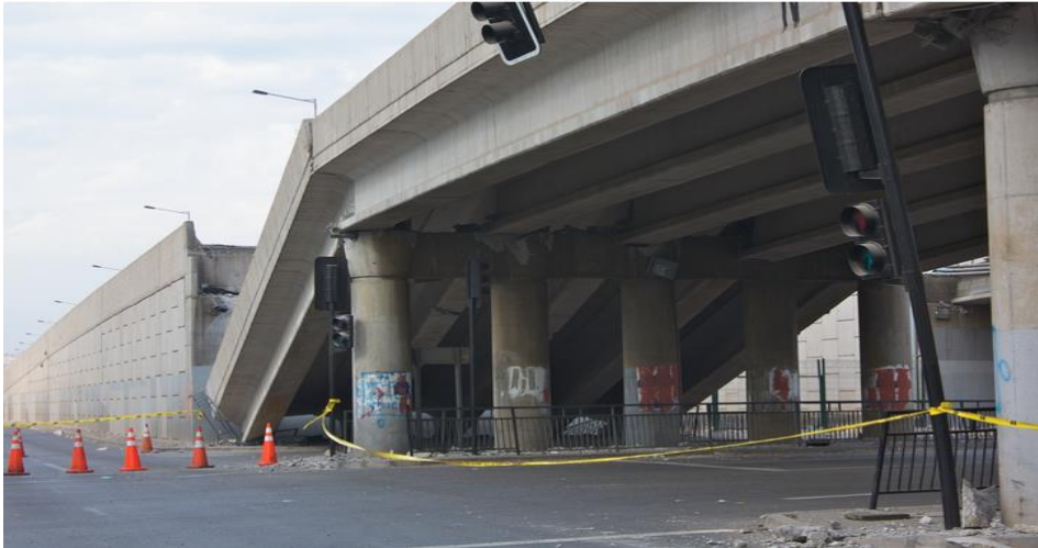
Figure II.3 : Effondrement d'un pont suite à un séisme
