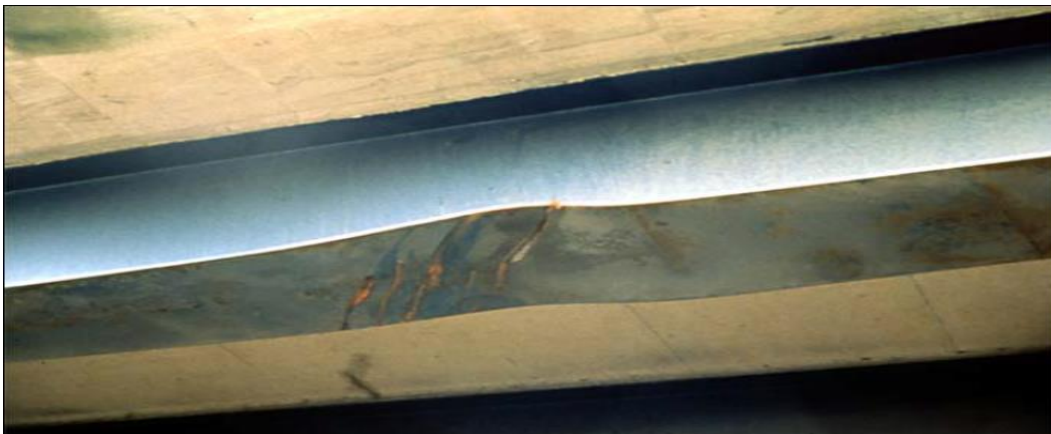
Figure II.4 : Déformation de la membrure inférieure d'une poutre principale dus au choc de véhicule
