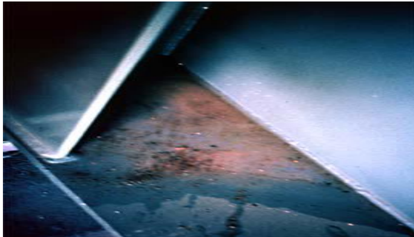
Figure II.10 Stagnation d'eau due à une mauvaise disposition constructive
