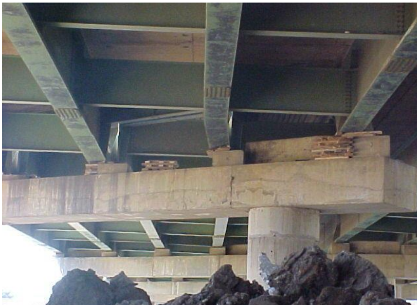
Figure V.35 Déformation de la poutre intermédiaire
