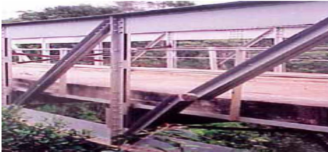
Figure II.7 : Rupture par fatigue d'une diagonale tendue sur un point de soudure
