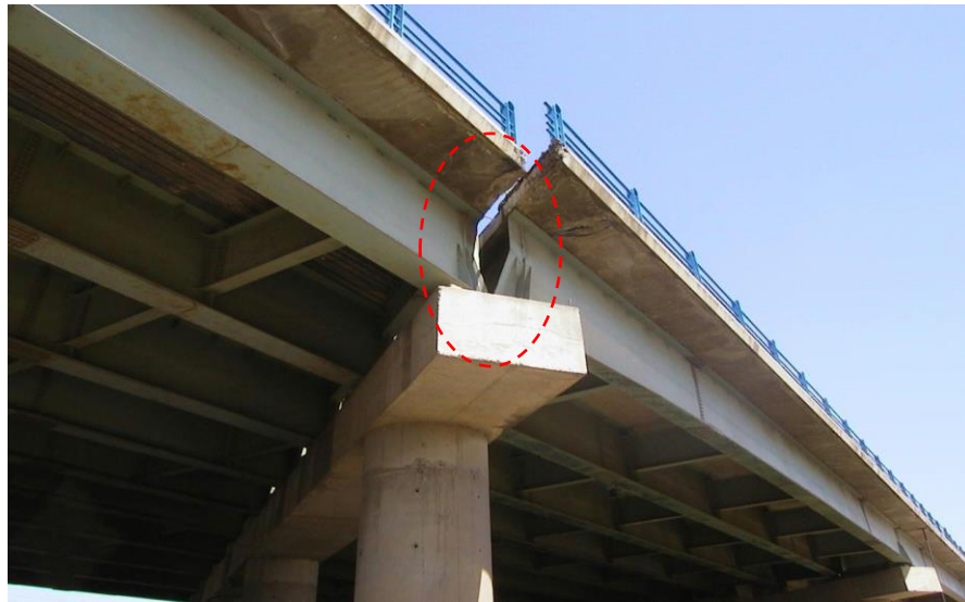
Figure V.27 Déformation de l'âme de la poutre de rive
