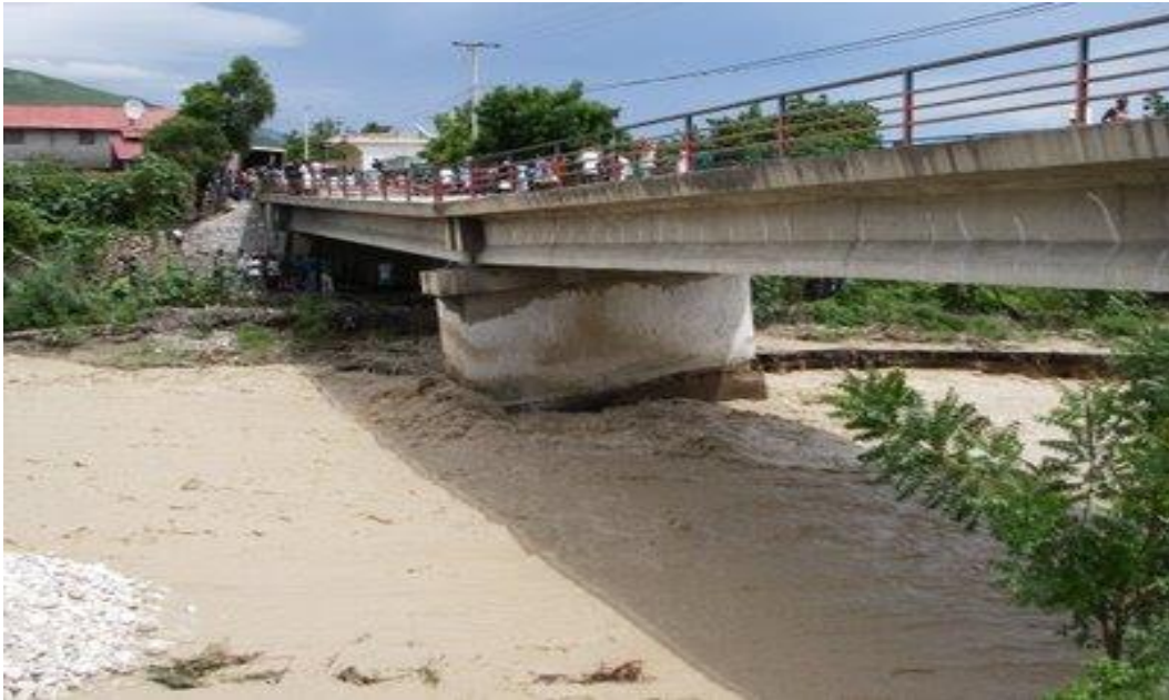
Figure II.2 : Affouillement des fondations d'une pile de pont
