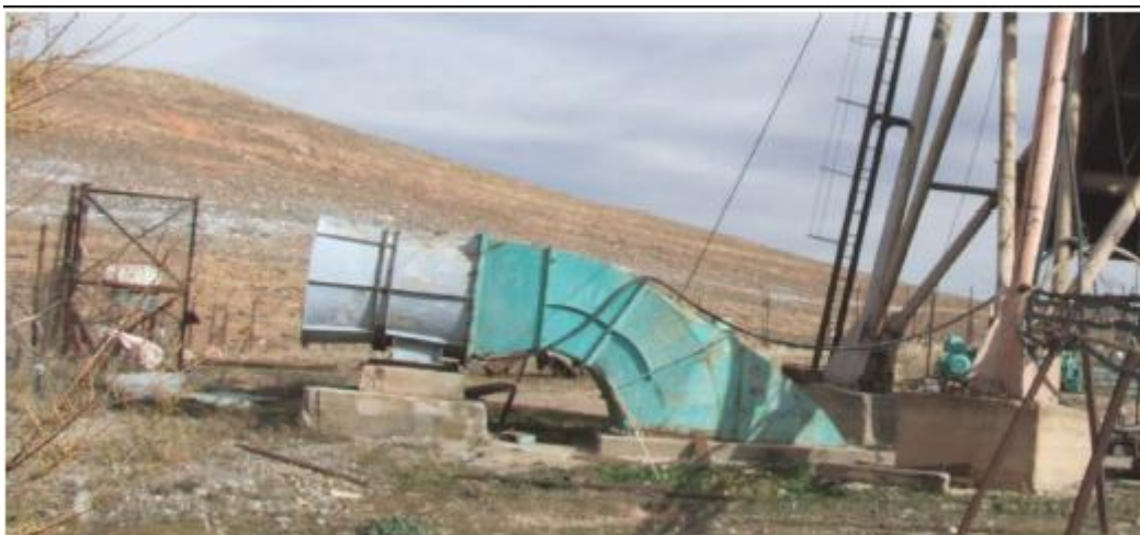
Figure III.12. Ventilateur aspirant de Chaabet El Hamra
