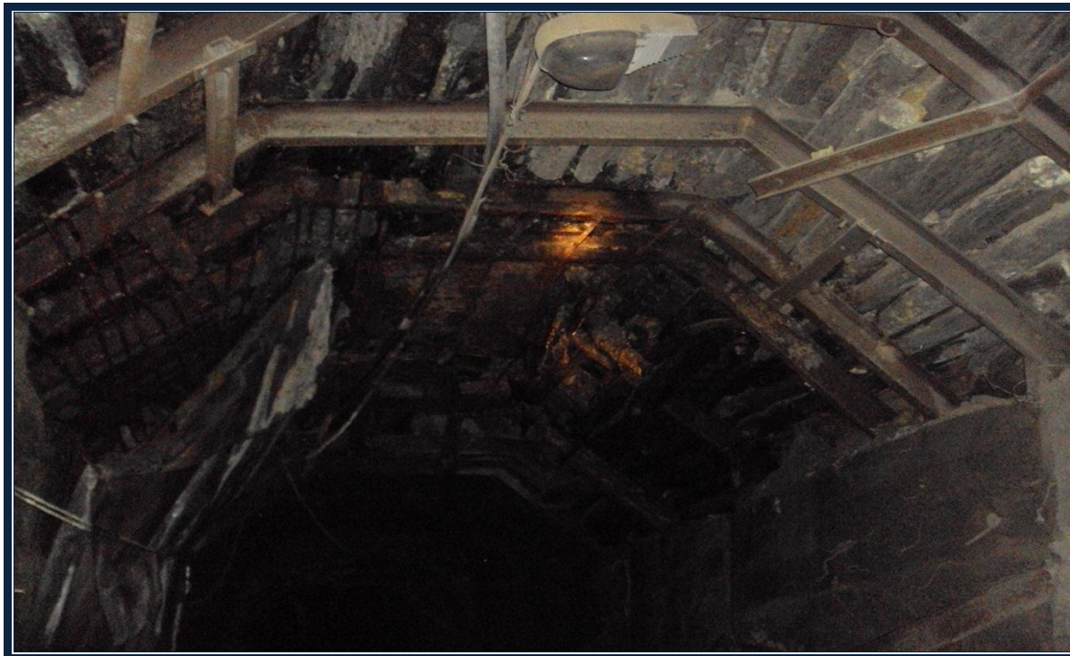
Figure III.10. Soutènement par cintres métalliques (la mine de Chaabet EL-hamra)
