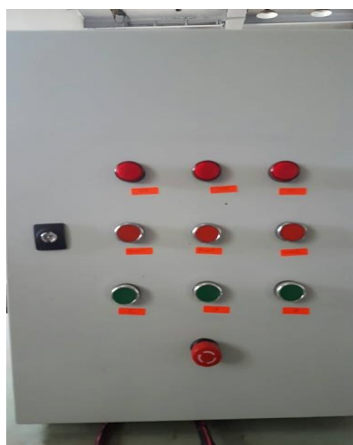
Figure 60 : les éléments de manœuvre et de signalisation.
