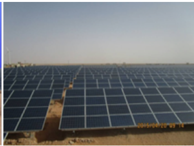
Centrale de Kabertène
