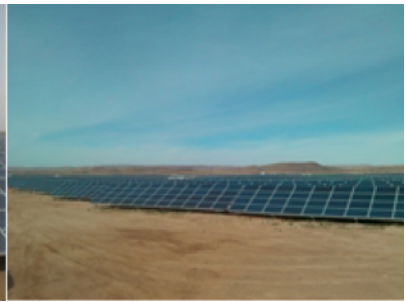
Centrale de Djelfa
