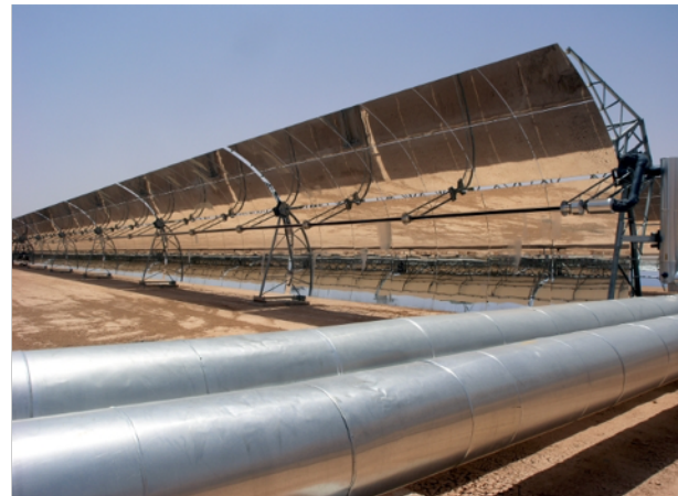
Centrale de Hassi R'mel dont 25 MW CSP
