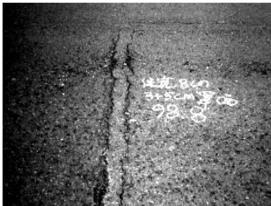
Figure I.2. Types de fissure réfléchive [Zhou, 2005]
