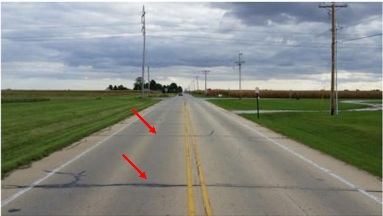
Figure.I.10. Fissures thermiques [Buttlar et al., 2018]
