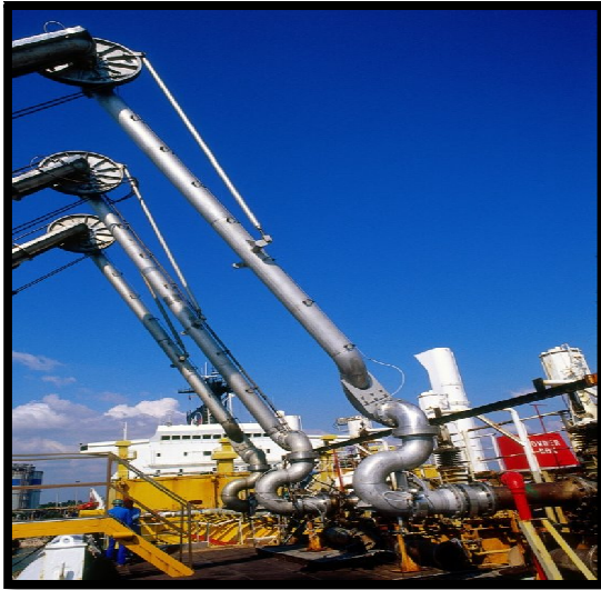
Figure. 2.4 Bras de déchargement du GNL
