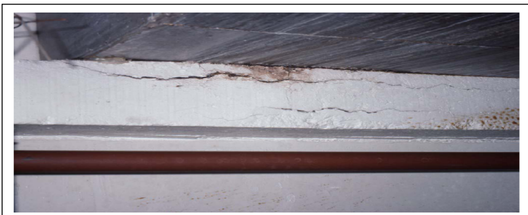
Figure I.2: Eclatement du béton d'une poutre [7].
