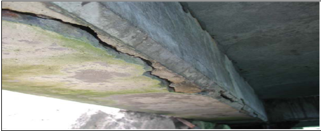
Figure I.3: Poutre de tablier de pont dégradée [6].
