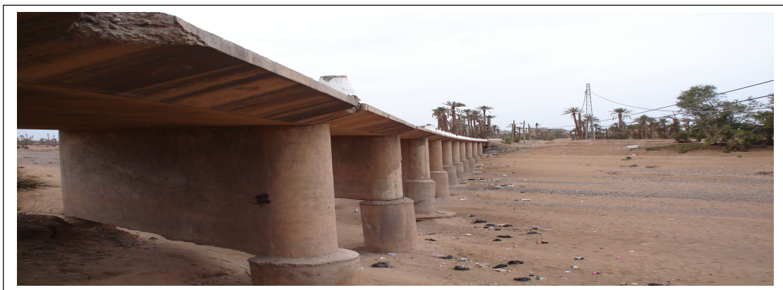
Figure I.1: Affouillement des semelles des piles d'un pont [8].
