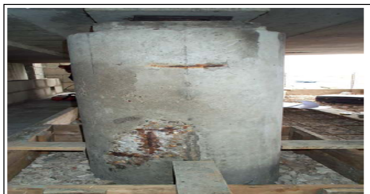
Figure I.5: Corrosion des armatures d'une pile de pont [7].
