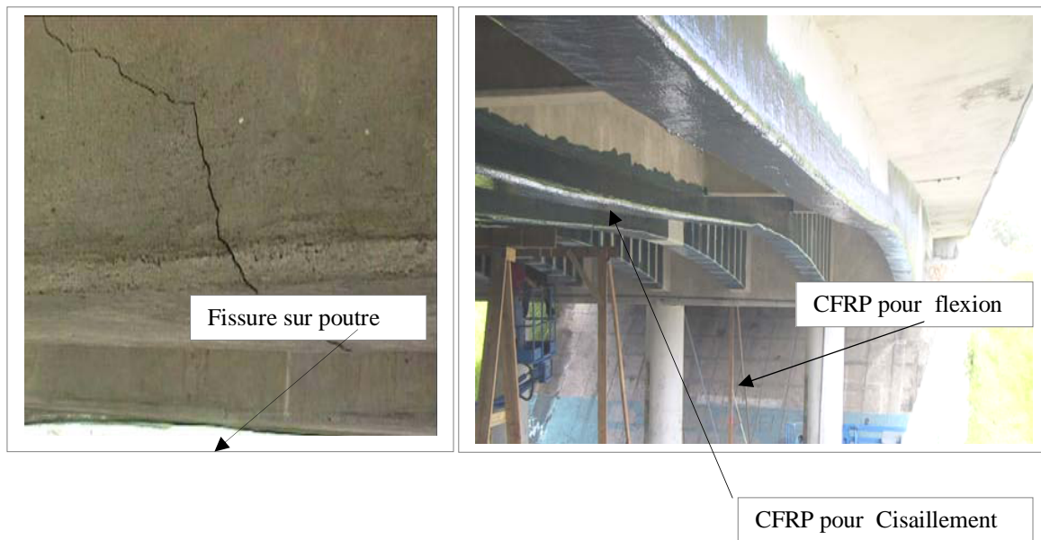
Figures III.26 et III.27: Fissure typique sur la poutre et application du CFRP [94]
