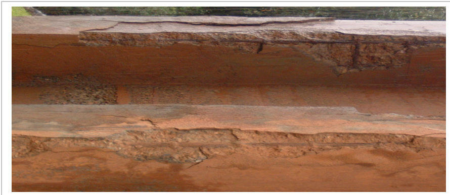
Figure II.19: Eléments en béton très détériorés avec aciers corrodés
