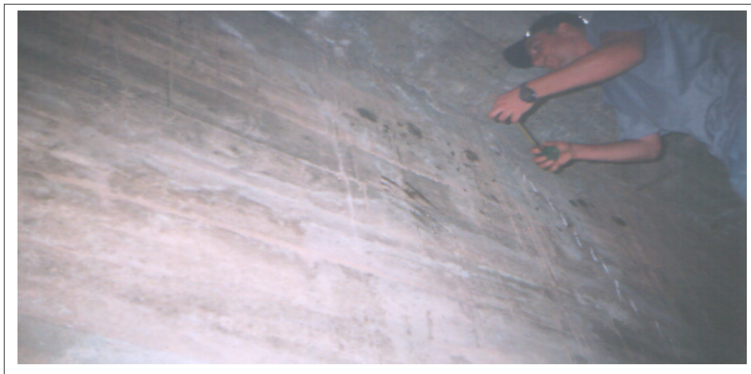
Figure II.21: Mesures ultrasoniques au droit d'une fissure
