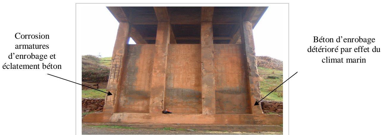
Figure II.18 Vue des dégradations apparentes sur la pile
