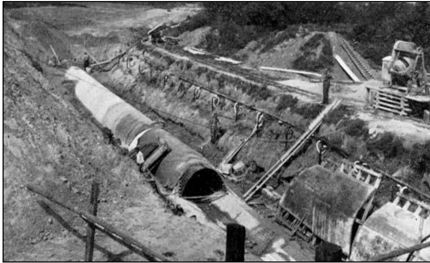
Photos 1.12 : Canalisation utilisée pour le transport des eaux usées Breda (Pays –Bas)
