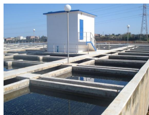
Figure IV- 7 : Photo du décanteur Pulsator
