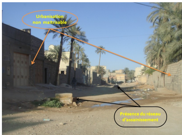
Photo IV-3 : existence du réseau d'assainissement dans le lit du cours d'eau
