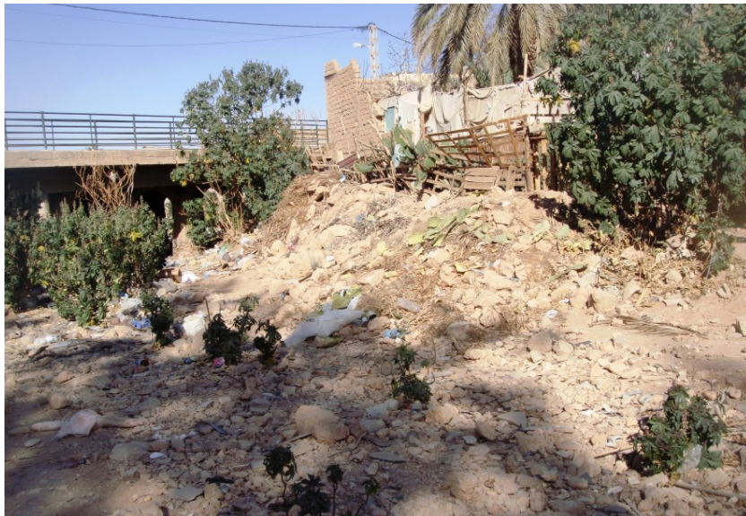
Photo IV-9 : glissement au niveau de la rive droite
