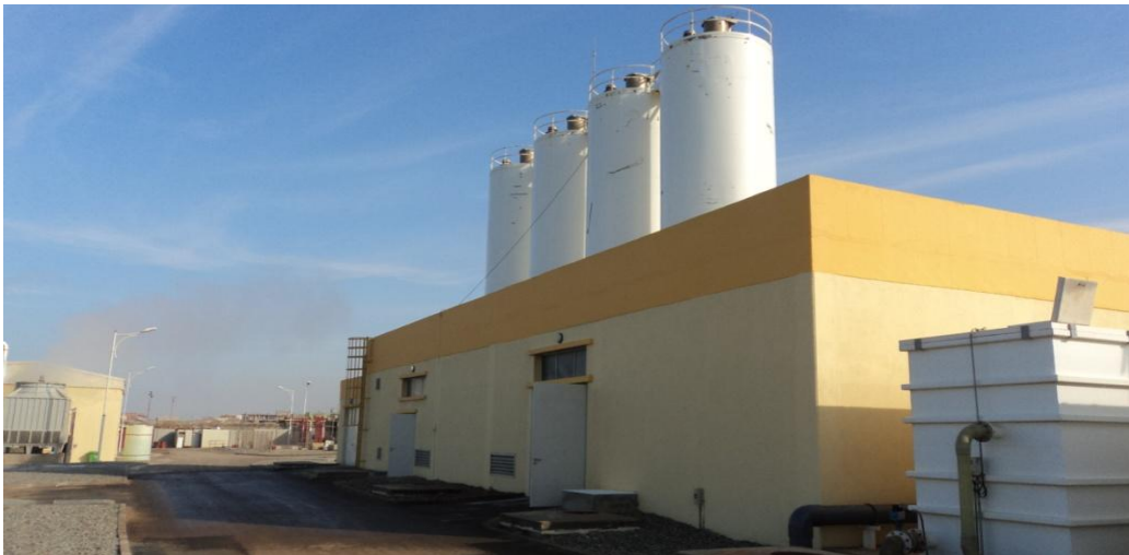
Figure II. 12: Silos de la chaux.
