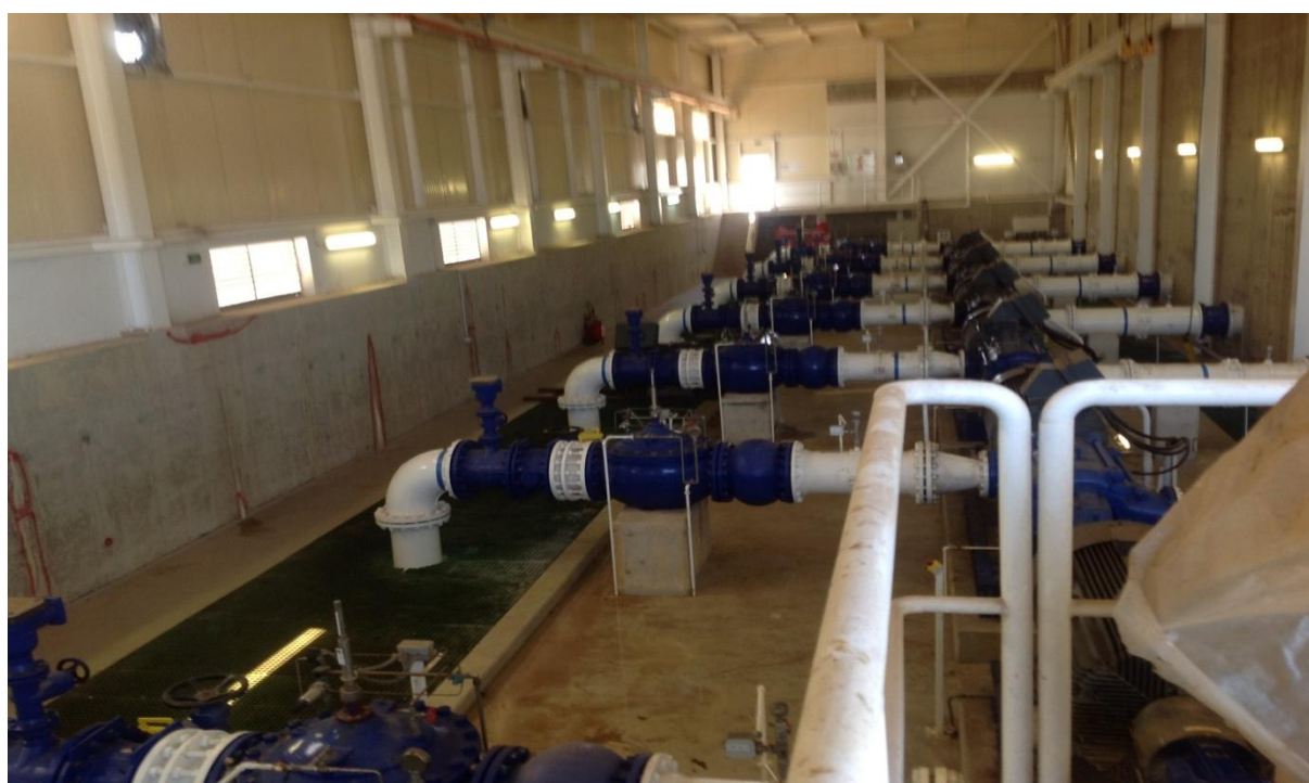
Figure II. 14: Station de pompage d'eau traitée.
