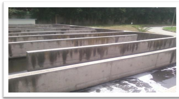
Figure IV.9 : Bassin de chloration.
