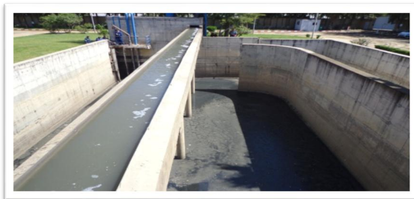
Figure IV.4 : Bassin d'orage de la STEP de BOUMERDES
