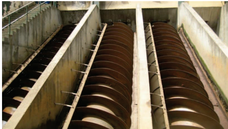
Figure IV.1 : photo des vis d'Archimède du poste existant
