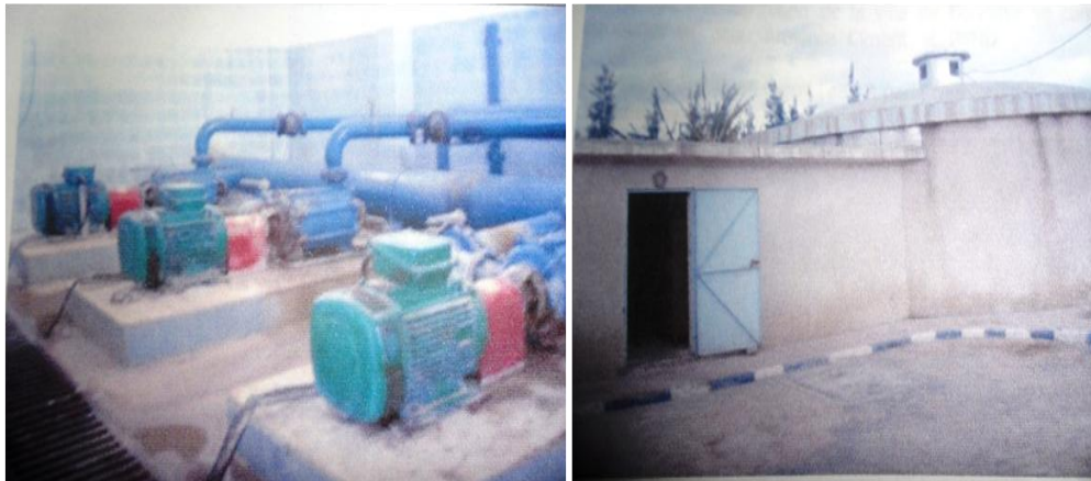
Photo V-5 : Station de pompage Brahim Ben Omar et le réservoir 2×500m 3
