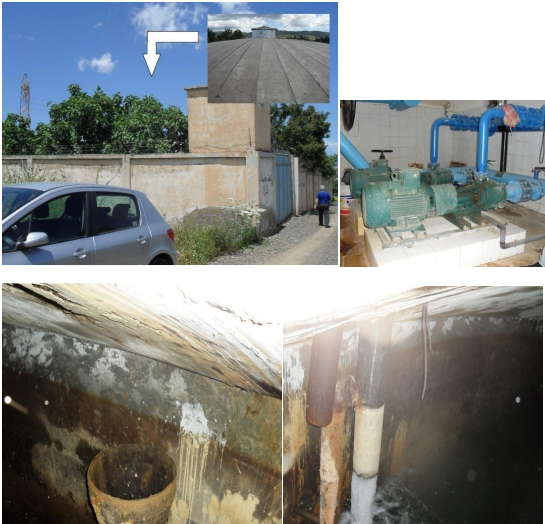
Photo V-6 : Réservoir 1000 m 3 et sa station de pompage
