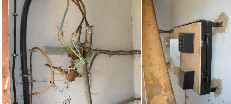
Photo V-2 : Les équipements électriques du forage F3 BIS
