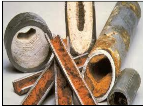
Photo II-3 : Formation de calcaire sur la paroi interne de la conduite
