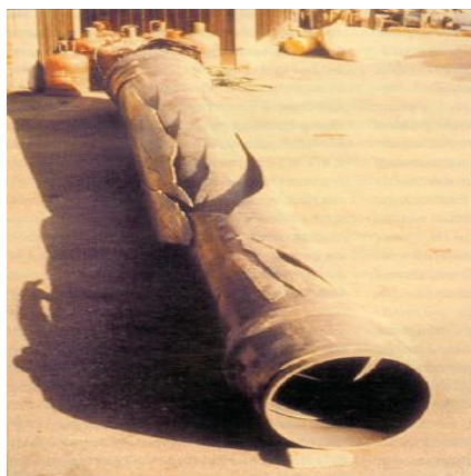
Figure 1 : conduite détruite à cause du coup de bélier.
