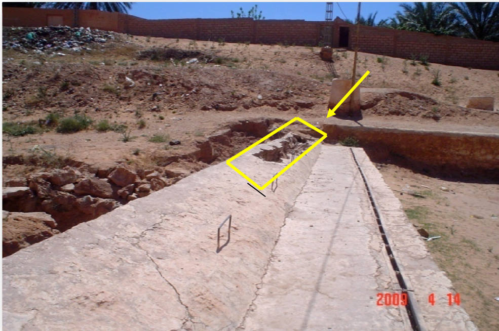
Photo III-8 : Rupture des Tissembads.
