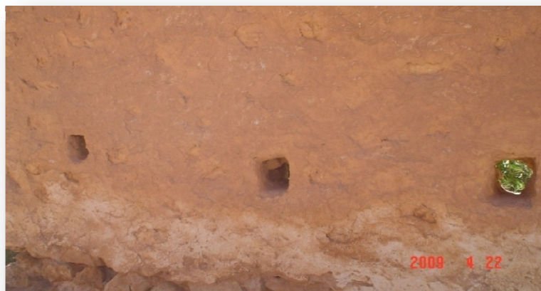
Photo II-15 : Trop-plein d'un jardin (dans une zone urbanisée).
