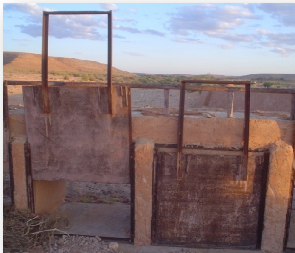
Photo II-3 : Les vannes de régulation de débit.
