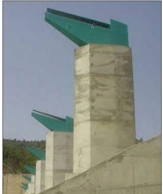
Figure III-19 : Photo des hausses fusibles barrage de Béni-Amrane..
