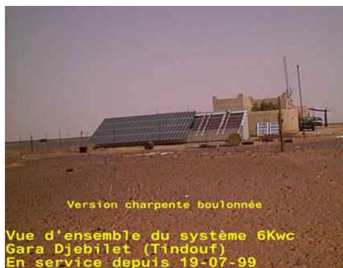
Figure 2.12: Système photovoltaïque installé à Gara Djebilet (Tindouf) 6 kWc
